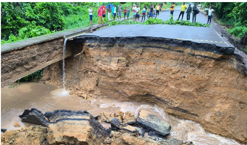
FIGURA 10. PUENTE CARUPANO-GUIRIA. FUENTE: HTTPS://CORREODELCARONI.COM/REGION/LLUVIAS-EN-SUCRE-COLAPSAN-VIA-QUE-COMUNICA-A-CARUPANO-CON-GUIRIA/
