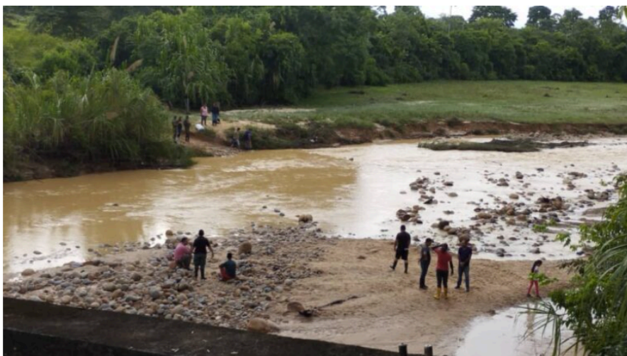
FIGURA 11. PUENTE SOBRE EL RÍO NULITA FUENTE: HTTPS://WWW.RADIOFEYALEGRIANOTICIAS.COM/SE-CAYO-EL-PUENTE-SOBRE-EL-RIO-NULITA-EN-APURE/
